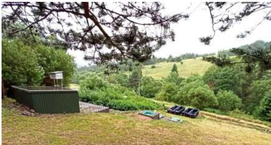
Fot. 100. Zestaw quasi technicznych obiektów do oczyszczania ścieków zawierający: zraszane złożo z wypełnieniem z kalcynowanych granulatów gliniasto-ilastych (keramzyt) oraz układ stokowych złóż filtracyjnych gruntowo-trawiastych - autorski projekt technologiczny ITP PIB - GCB w Tyliczu. (A. Jucherski, A. Walczowski, G. Skalniak).
