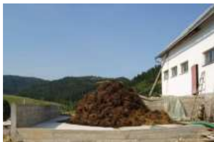
Fot. 81. Szczelna betonowa płyta do składowania obornika w gospodarstwie o chowie bydła
